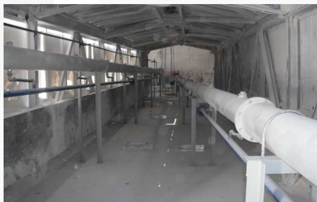
Pohled na uložení dopravních tras ve spojovací chodbě nad síly
