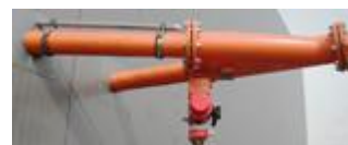
Rozbočka dopravního potrubí
