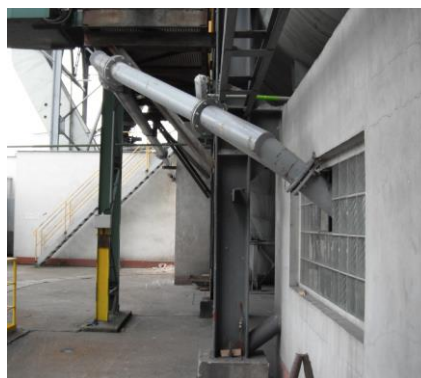
Ohyb dopravního potrubí na počátku dopravní trasy
