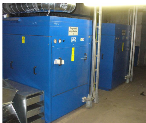
Pracovní a rezervní dmychadlo dálkové dopravy
