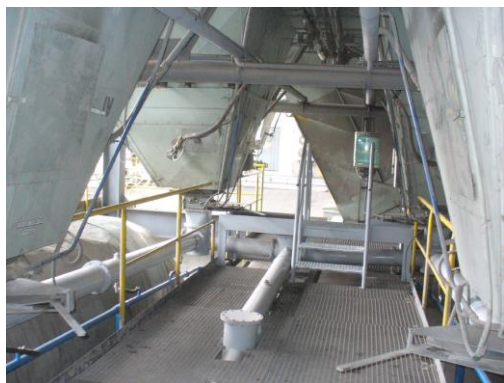
Sběrné fluidní dopravníky pod výsypkami EO
