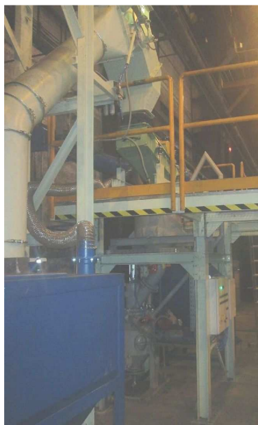
Obr. 1: Pohled na zařízení
