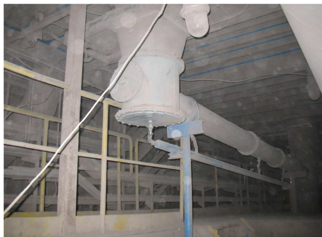
Obr. 1: Začátek fluidního dopravníku pod filtrem
