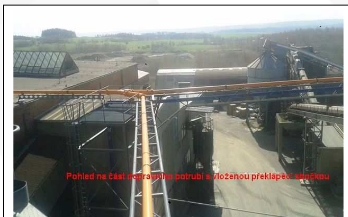
Obr. 1: Dopravní potrubí se sbočkou
