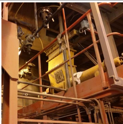
Pohled na část původního zařízení - šnek
