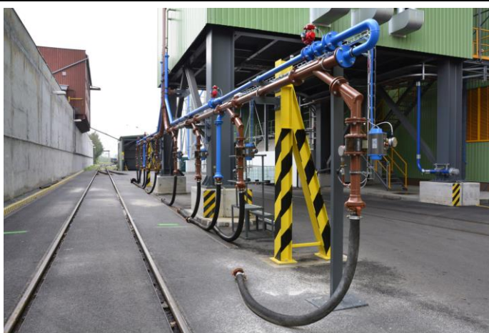
Z exkurze – poloautomatická stáčekí stanice vápence z vagonů Raj
