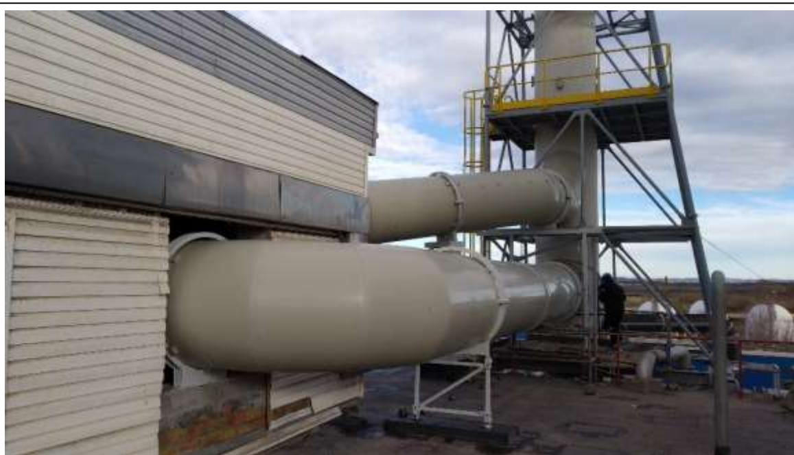
Plastové vzduchotechnické potrubí DN 1200
