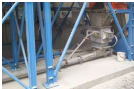
Původní směšovač s chybným odvodušněním komor rotačního podavače
