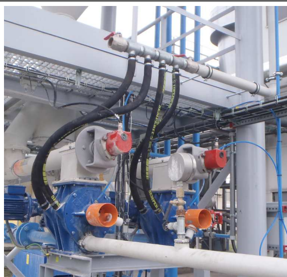
Odvzdušnění rotačního podavače s přísátím
