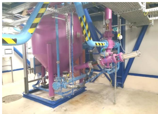
Uložení podavače na tenzometrech a počátek dopravní trasy s uzávěrem PMU a uvolňovacím ústrojím RPRS
