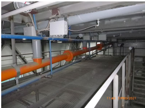
Příčné odvaděče odprašků napojené do podélného fluidního dopravníku
