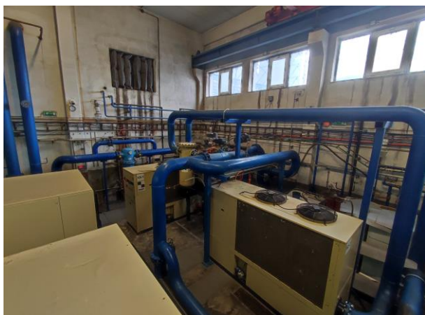
Stávající stav rozmístění technologie sušičů
