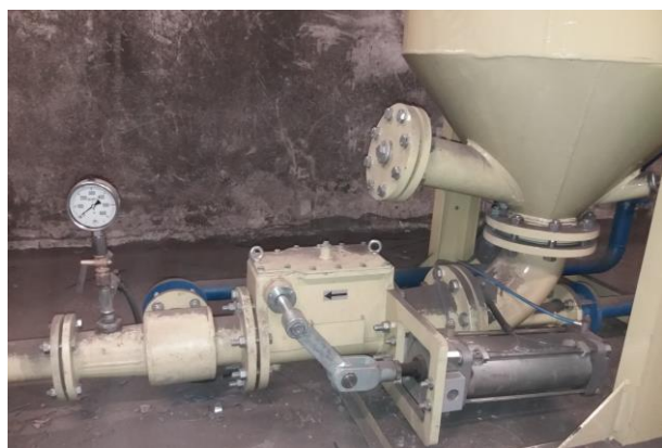
Uzávěr KMU a přífuk do dopravního potrubí
