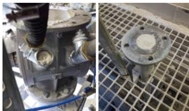
Ucpané odvodu vzduchu rotačního podavače
