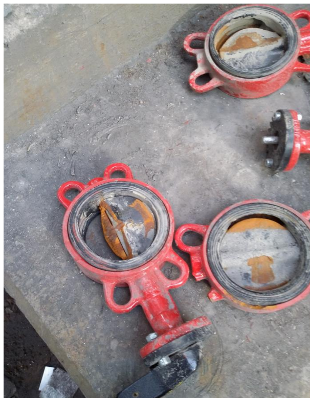
Otěrem poškozené motýlové klapky
