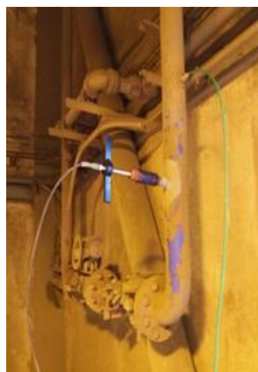
Měření průtoku vzduchu (vlevo) a tlaku (zelená hadička vpravo)
