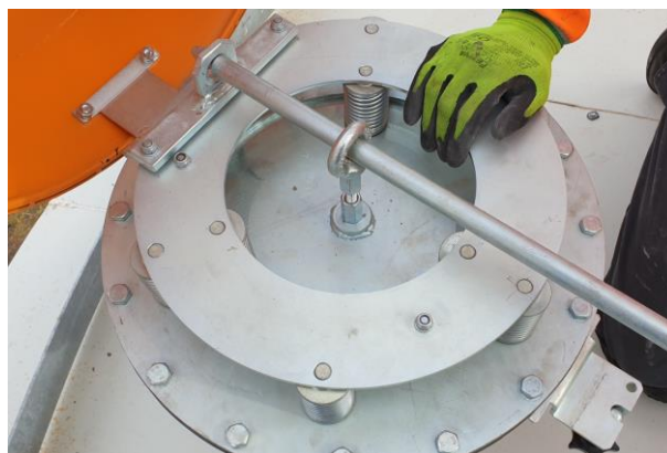
Funkční část pružinového odlehčovacího ústrojí přetlak/podtlak při kontrole
