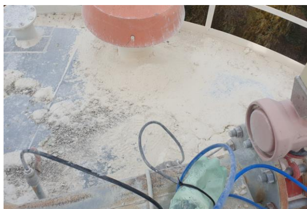
Důkaz správné funkce odlehčovacího ústrojí – vyfouklý prach dokazuje, že bylo v činnosti
