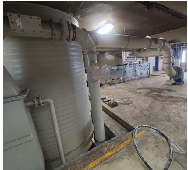
Venturiho pračka, VZT jednotka a ventilátor
