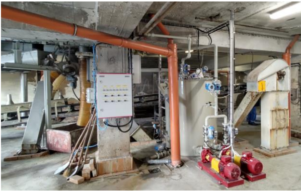
Cirkulační nádrž a čerpadla
