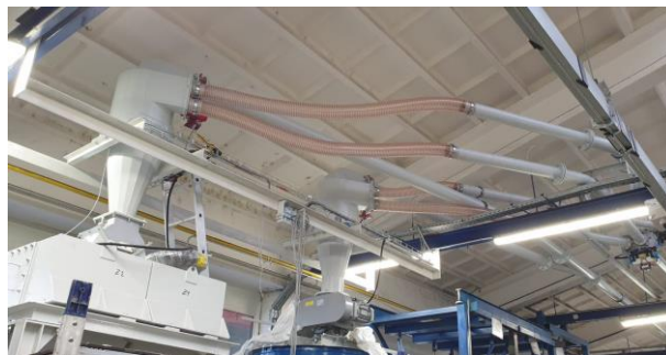
Propojení dopravních potrubí s cyklony spirálovými hadicemi
