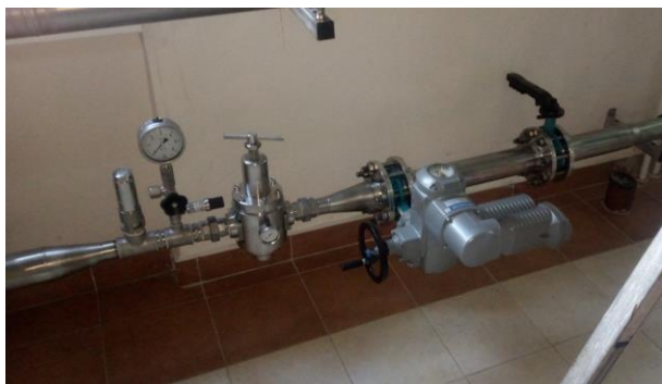
Redukční stanice tlakového vzduchu
