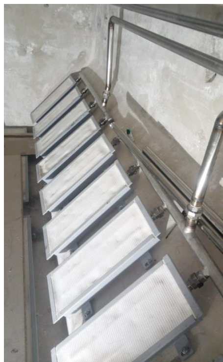
Řada (2 sekce) provzdušňovacích skříní PSB v silě (před vyplněním mezer mezi skříněmi)
