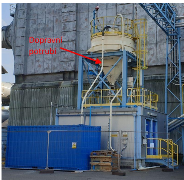
Celkový pohled na zařízení (potrubí vlevo)
